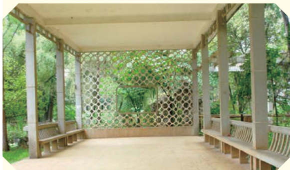
休息廊维修前1
