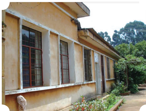
工作间外立面维修前
