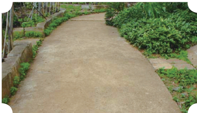
道路系统维修前
