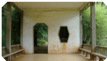
休息廊维修前2
